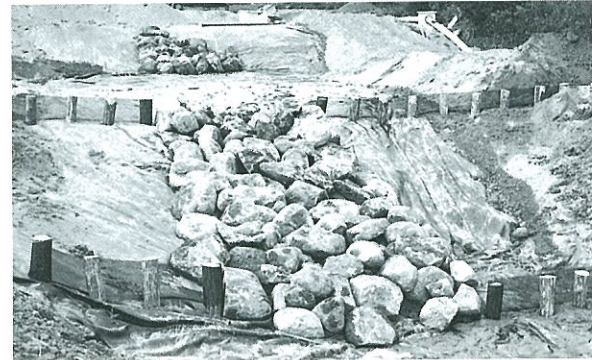
写真6. 表層土壌滑落防止のための松杭とネット 段間の急傾斜地の水路部分は石組に作り変えた。
