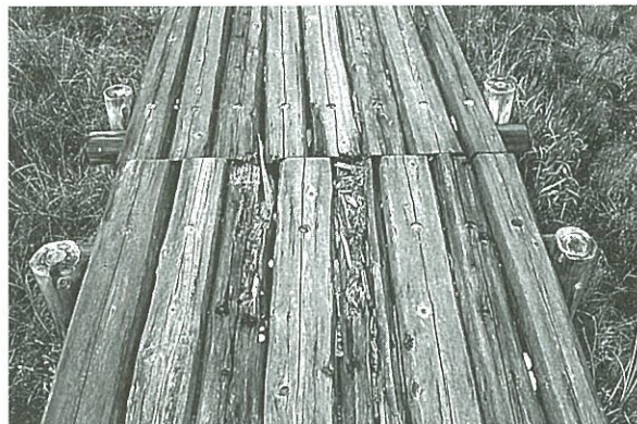
写真5. 痛んできた木道. 継ぎ目から腐り始め、続いて座板が折れた.
