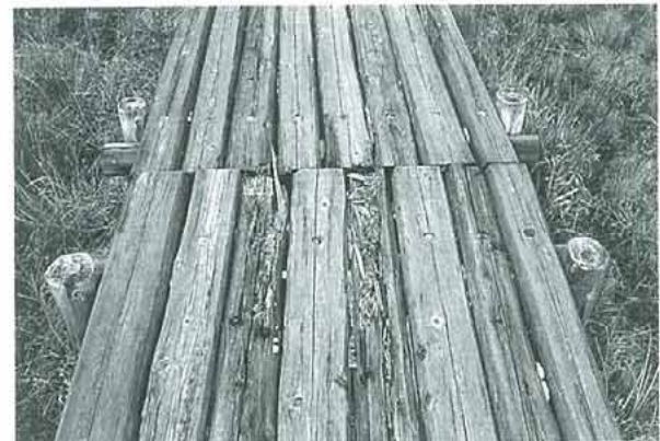
写真11. 痛んできた木道. 折れて浮き上がってくることもあった (1995.3.5).
