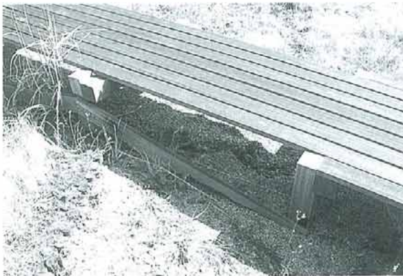
写真14. 木道の下に新たに入れたまさ土が雨で流された(1998.2.27).
