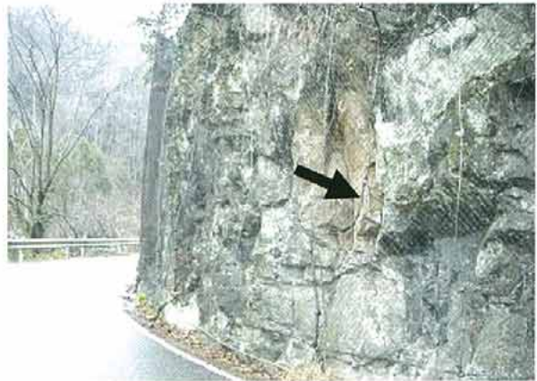
写真9. 金網防護の例. 矢印部のひび割れた隙間で ヤモリ類の卵が確認された.
