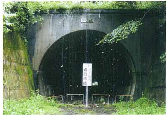
写真7. 全面金属ネットで封鎖されたトンネル (真庭郡湯原町, 2007年8月29日).
